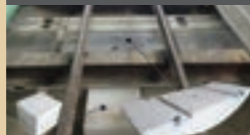
歩床ブロック インパットブロック 千葉県印西エリア洞道新設工事(その2) 発注者: 東京電力パワーグリッド㈱
